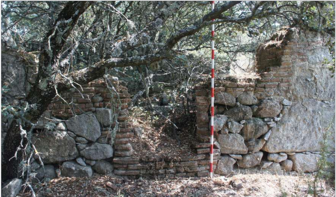
Figura 6.- Detalle de la fachada del área de vivienda del edificio de taller de laboreo de mármol. (Gómez Osuna, 2018).
